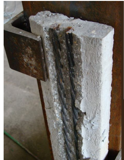
Fot.7 Zerstörung des Balkens L2.
